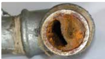
Potrubí s usazeným vodním kamenem
