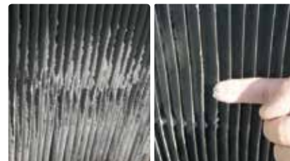
Mřížka chladící věže
